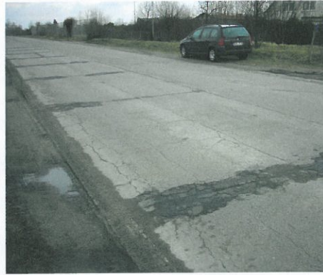
Bild 4: Fahrbahnzustand zum Zeitpunkt der Begutachtung, 1. Bauabschnitt: km 0+440
