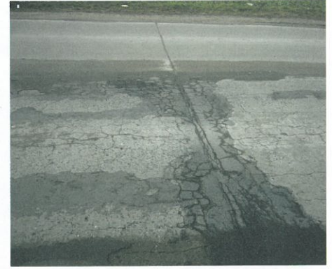
Bild 5: Schadhafte, mit Asphalt geflickte Kantenabplatzungen an Quersfugen sowie Netzrisse, resultierend aus Alkalikieselsäureschädigungen
