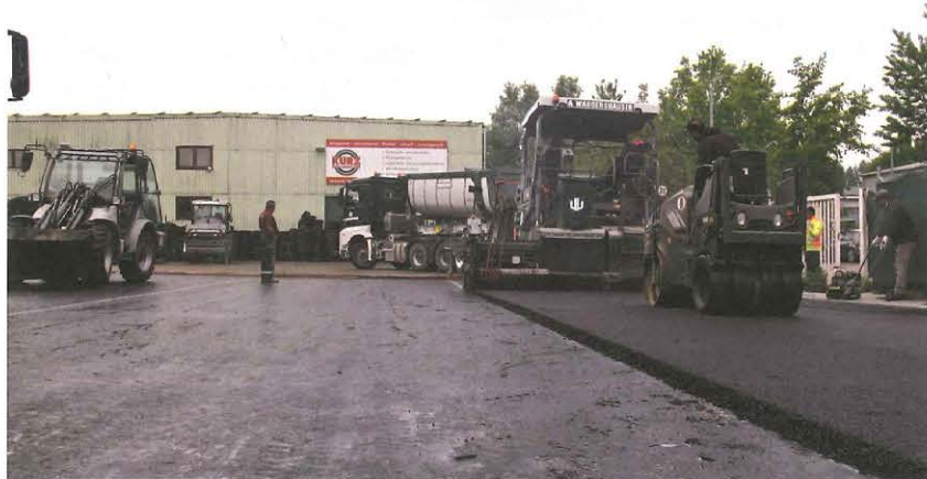
KURZ Karkassenhandel verlegt in einem Pilotprojekt Gummiasphalt auf dem Firmengelände in Wendlingen, Quelle: KURZ Karkassenhandel
