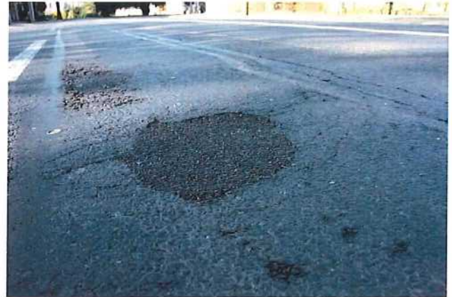
Abb. 4.29: während der ersten Kontrolle
