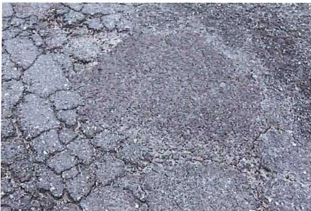
Abb. 4.3: während der zweiten Kontrolle (geringe Setzung erkennbar)
