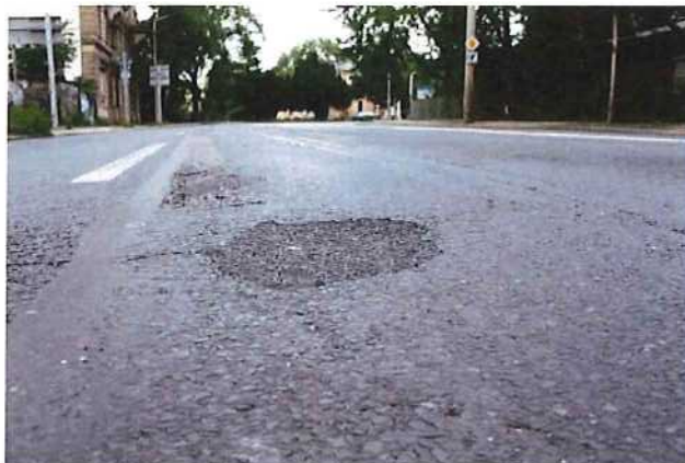
Abb. 4.30: während der zweiten Kontrolle (geringe Setzung erkennbar)
