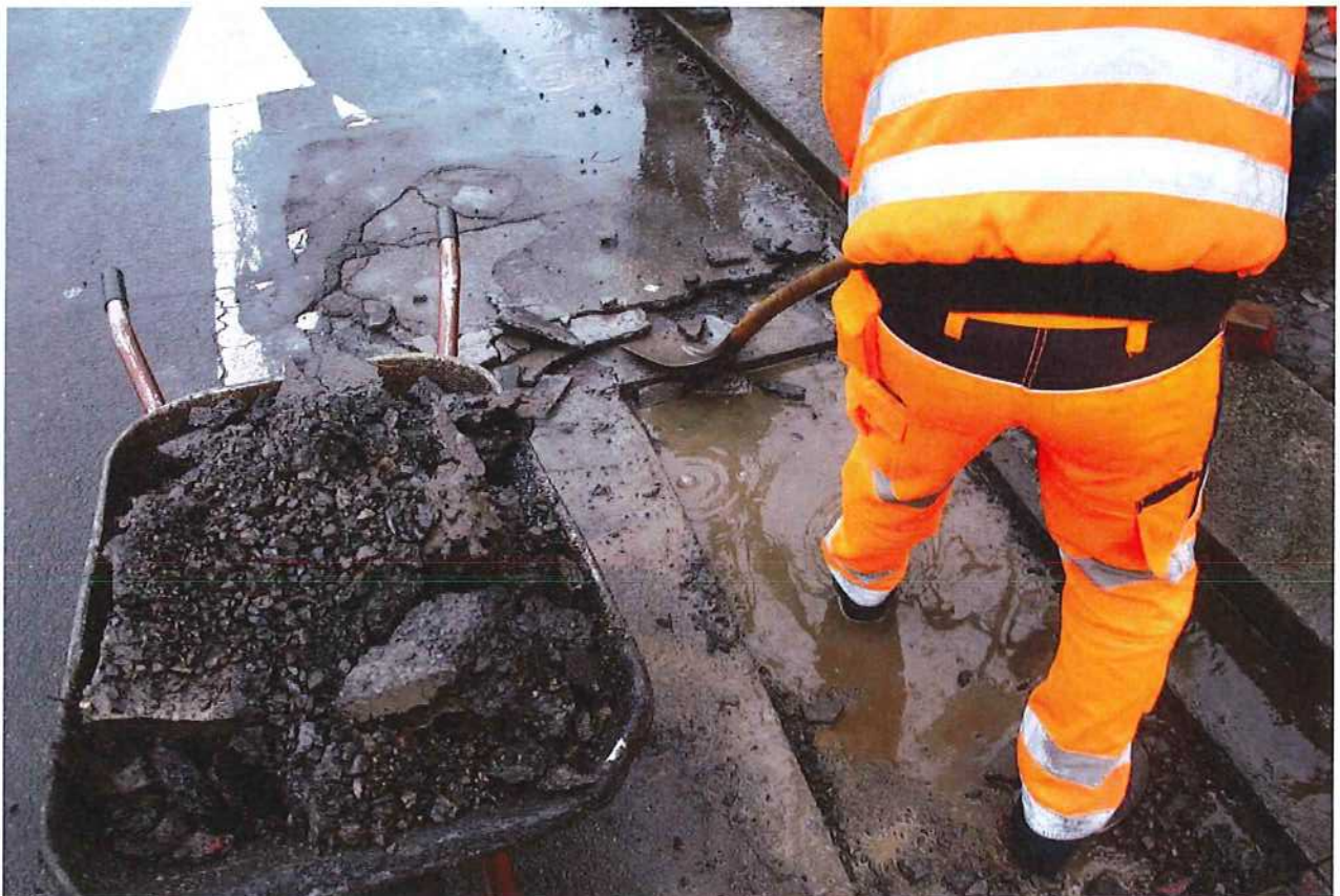
Abb. 2.14: Versuchsstelle 8: Nach dem Aussägen, fehlender Schichtenverbund erkennbar
