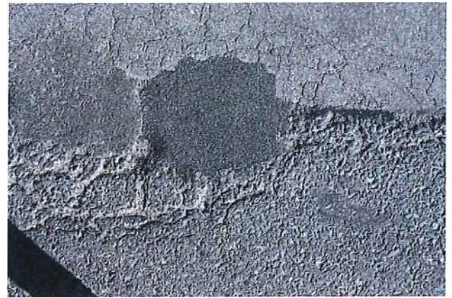
Abb. 4.66: während der ersten Kontrolle
