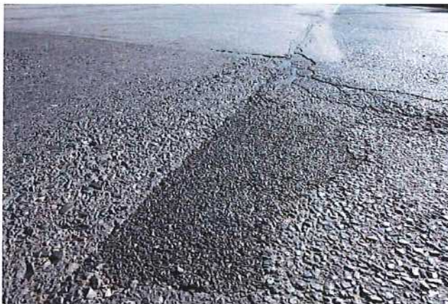
Abb. 4.58: während der ersten Kontrolle
