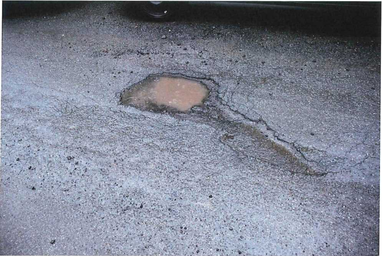
Abb.1.3: Versuchsstelle 2: Schlagloch gesamt
