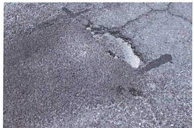
Abb. 4.22: während der zweiten Kontrolle (Ausbruch neben Verfüllung)
