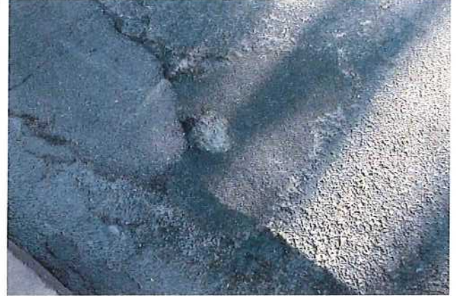
Abb. 4.41: während der ersten Kontrolle
