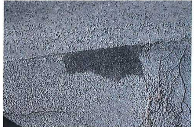
Abb. 4.57: während der ersten Kontrolle
