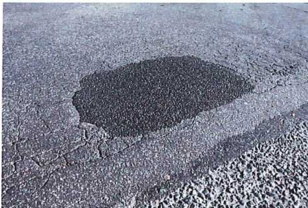
Abb. 4.73: während der ersten Kontrolle
