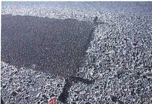
Abb. 4.81: während der ersten Kontrolle
