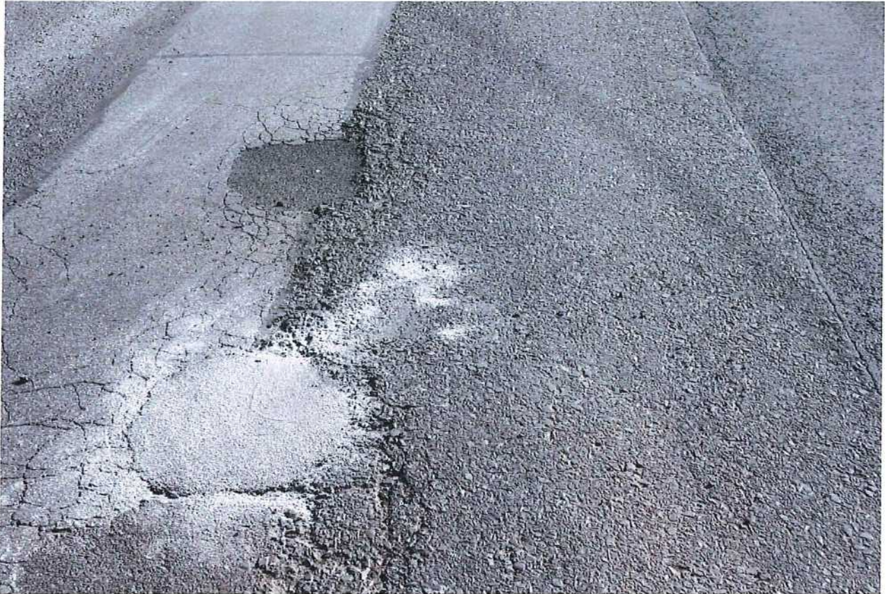
Abb. 3.8: Versuchsstelle 10: Nach dem Abstreuen mit Brechsand, oberhalb ist ein weiteres mit Kaugummiasphalt® saniertes Schlagloch zu sehen
