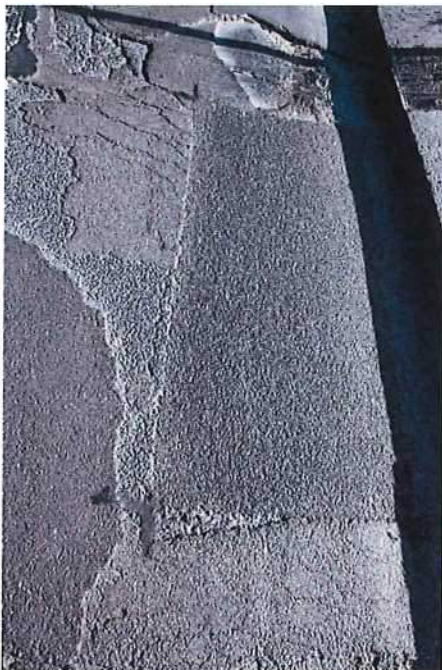
Abb. 4.47: während der ersten Kontrolle
