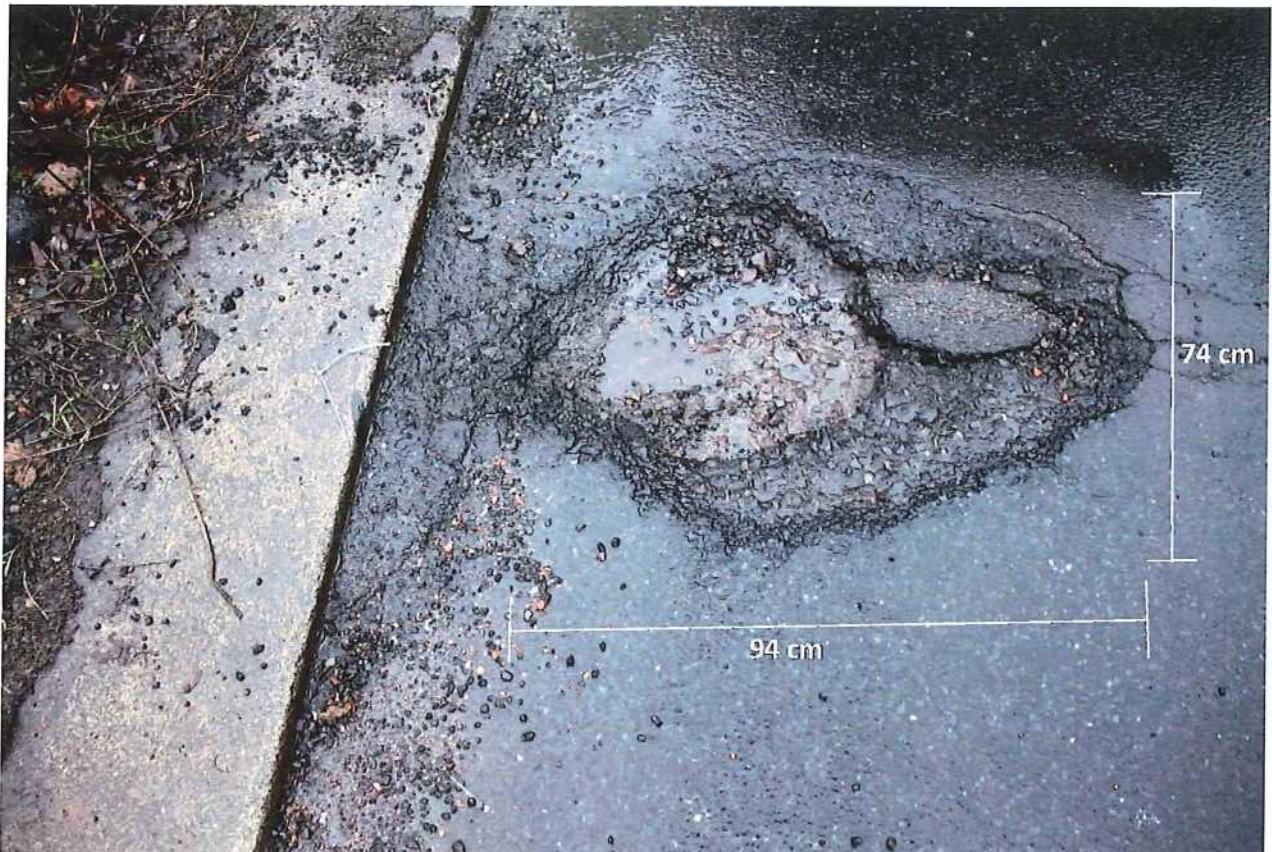
Abb. 2.3: Versuchsstelle 6: Vor dem Vorbereiten des Schlagloches (Tiefe ca. 10 cm)
