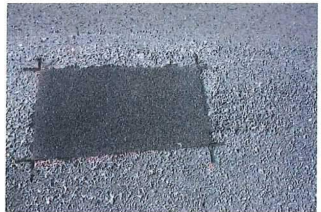
Abb. 4.80: während der ersten Kontrolle
