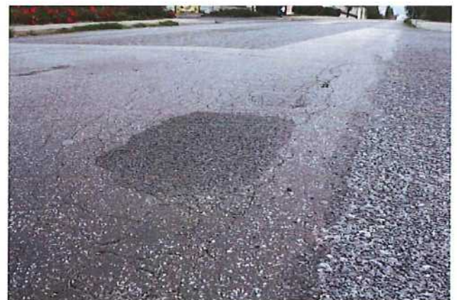
Abb. 4.75: während der zweiten Kontrolle (keine Unterschiede erkennbar)
