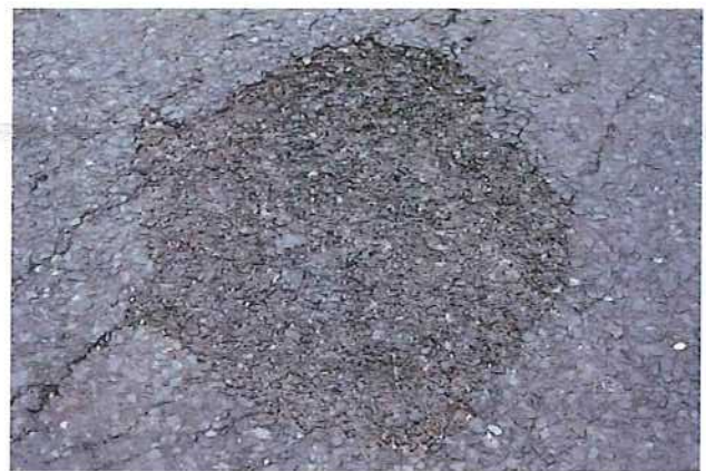
Abb. 4.31: während der zweiten Kontrolle (geringe Setzung erkennbar)
