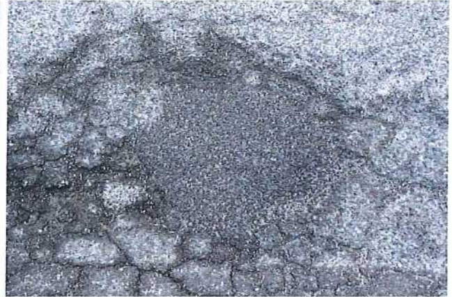
Abb. 4.2: während der ersten Kontrolle
