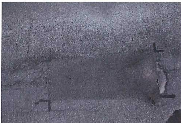
Abb. 4.21: während der zweiten Kontrolle (Ausbruch neben Verfüllung)
